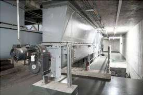
Bild 4: Dosierschnecken geben das Brennmaterial nach und nach auf die Fördertechnik, die dieses in den Vorlagebehälter des Kesselhauses transportiert.
