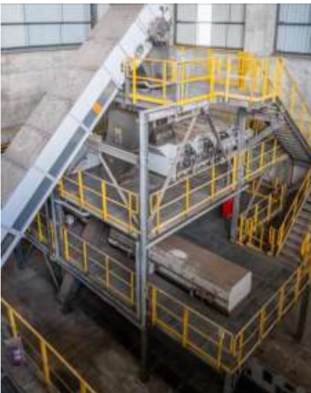
Bild 4: Ein Trommelmagnet zieht zuverlässig eisenhaltige Störstoffe aus der Masse, dann durchläuft das RDF ein Scheibensieb, um Partikel größer 70 Millimeter von der Masse zu trennen. Anschließend kommt das Material auf eine Bandwaage.
